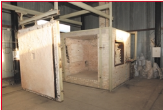
Печь для проведения огневых испытаний инженерных конструкций с оригинальной дверью
